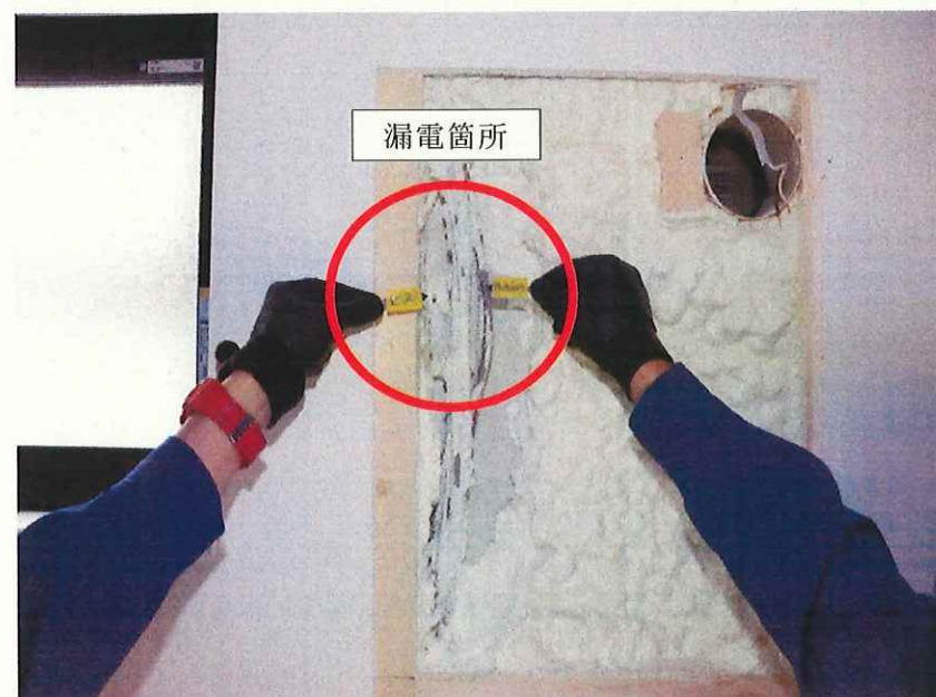
(写真3) 漏電箇所の状況
