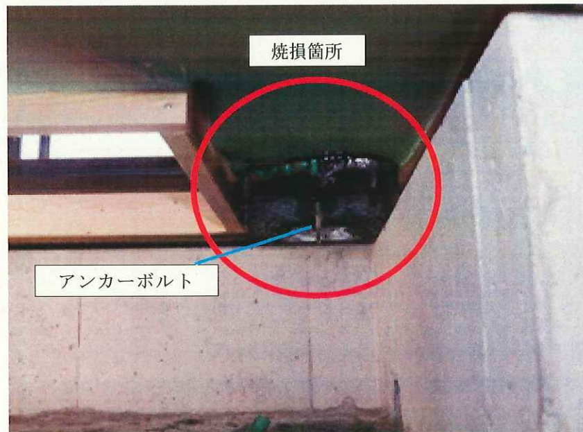
(写真2) 床下収納庫内から見た焼損状況
